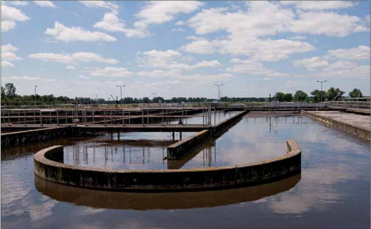
Die biologische Abwasserbehandlung (anoxe Zone)
